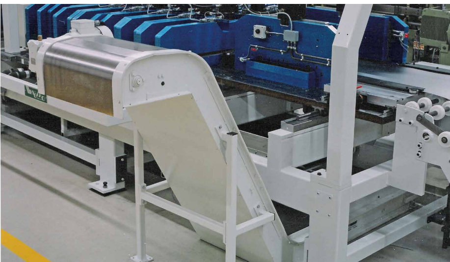
Pod razícím strojem se nachází dopravník, který odstraňuje kovové špony.
